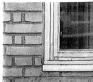
Billederne viser typiske tilfælde af ødelagt vinduesmaling
