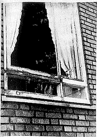
Billedet illustrerer kondensvandets ødelæggende virkning på vinduesmaling. Bemærk den mindre ødelæggelse på vinduets højre side, hvor rammen svinger indad, og hvor kondensvandet ikke kan samle sig i falsen
